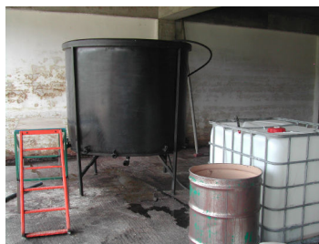
Πιλοτική μονάδα επεξεργασίας υγρών αποβλήτων ελαιοτριβείου
